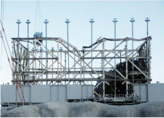
図 6 事故後 1F(1号機建屋)の状況(2019年撮影)
