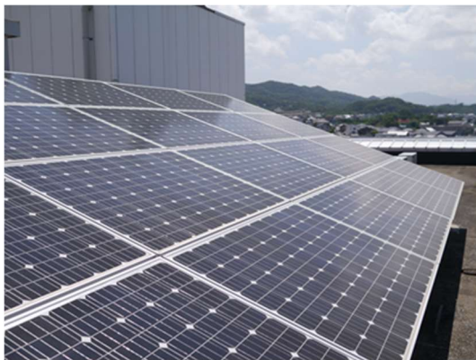
太陽光パネル
