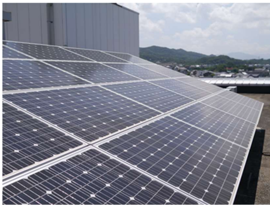
太陽光パネル
