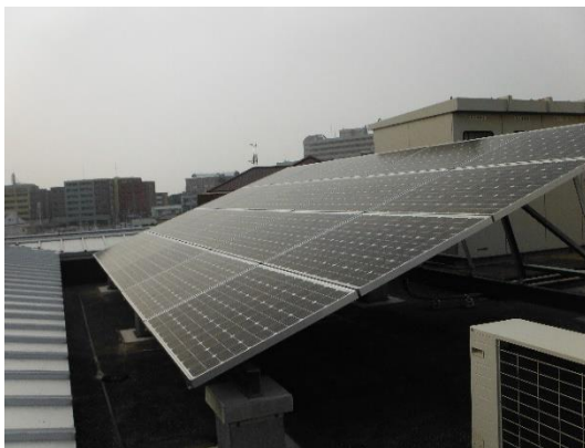
太陽光パネル
