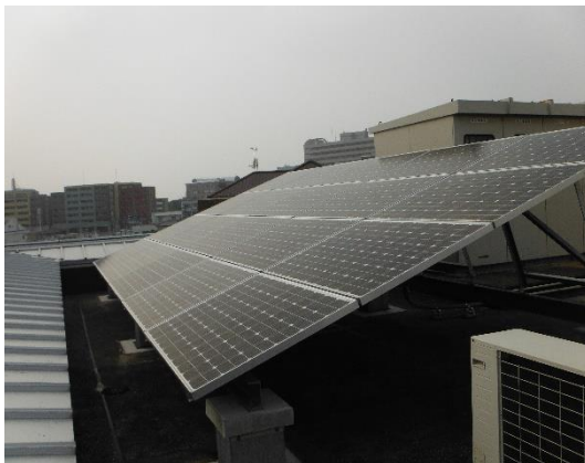
太陽光パネル
